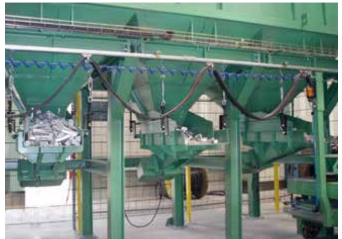
Instalaciones ferroaleaciones Ferroalloys dosing system
