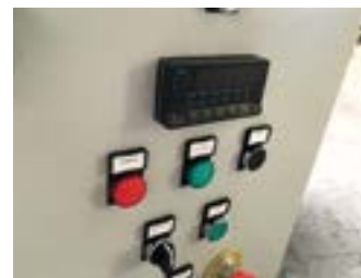
Armario eléctrico de control
