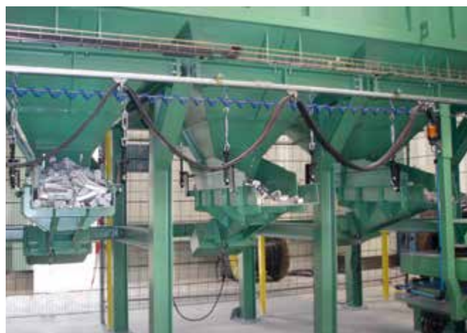
Installations pour ferro-alliages Ferroalloys dosing system
