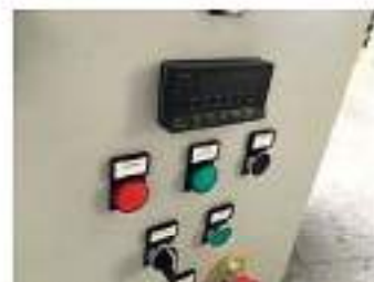
Armoire électrique de contrôle
